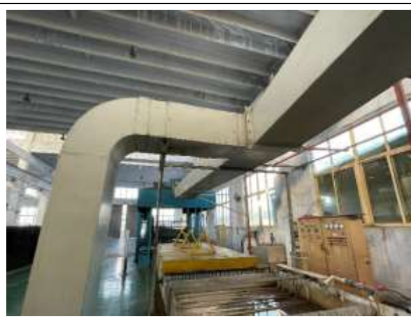
废气收集管道
