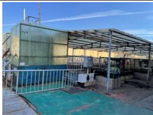
热镀锌、电镀废水处理区
